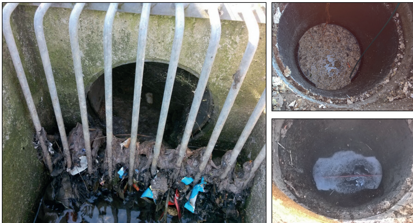
Figuur 1: Vervuiling bij een hemelwateruitlaat (links) en in putten van het hemelwaterstelsel (rechts)
